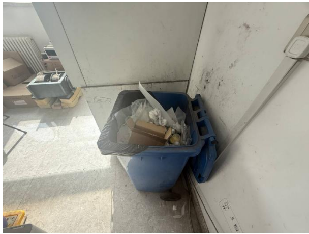
理工楼 1420: 卫生脏乱差
