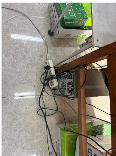
理工楼 1322：插线板放在地面
