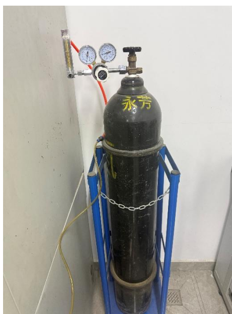
理工楼 1418：多个气瓶未悬挂标签
