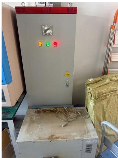
理工楼 1401：重物阻挡电源柜门
