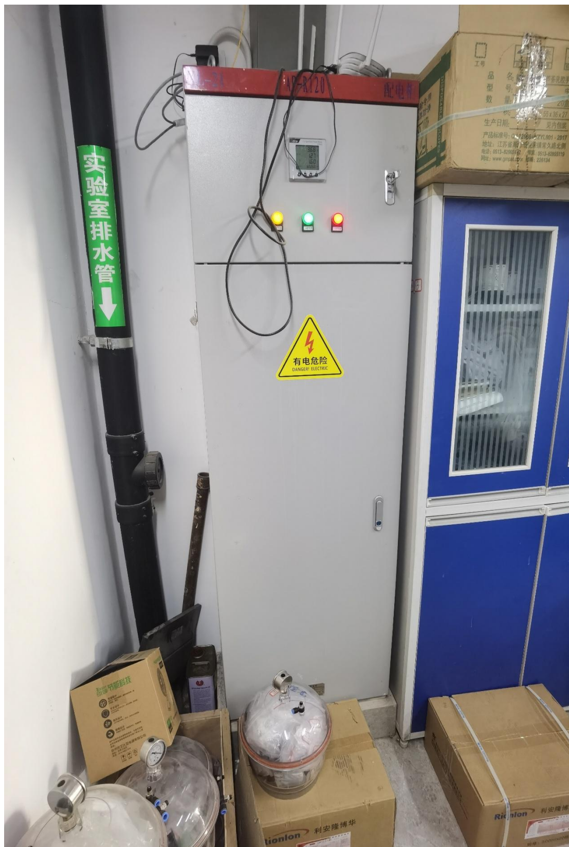
理工楼 1312: 电源柜门遮挡, 电源柜上电线隐患
