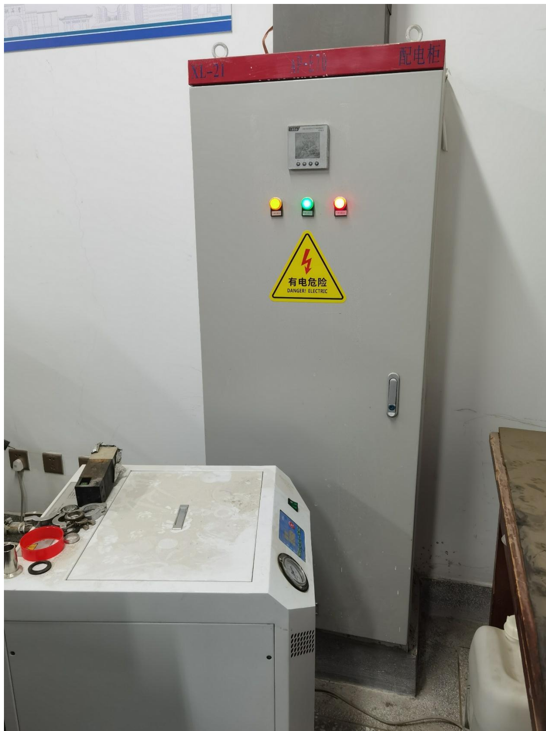
理工楼 112: 电源柜门被重物遮挡
