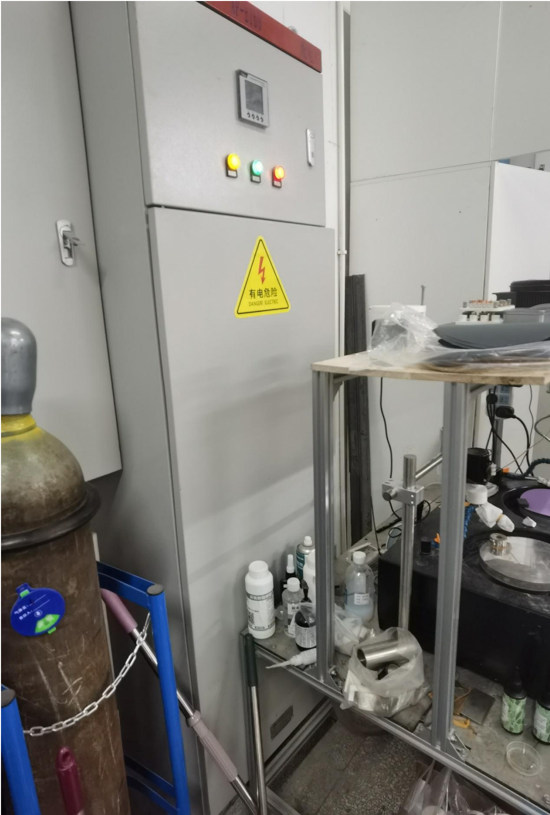
理工楼 111: 重物阻挡电源柜门
