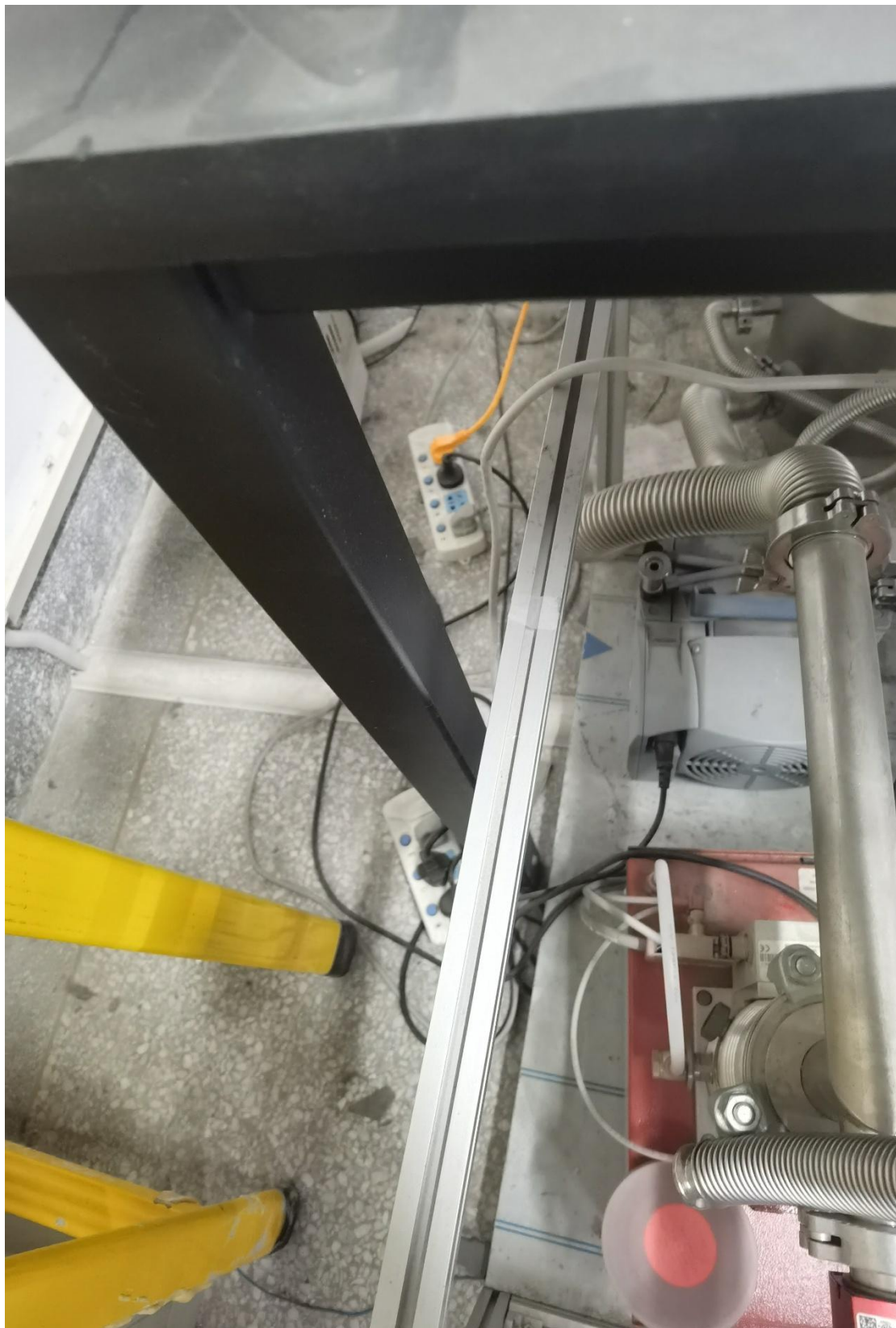
理工楼 122: 插线板放在地上
