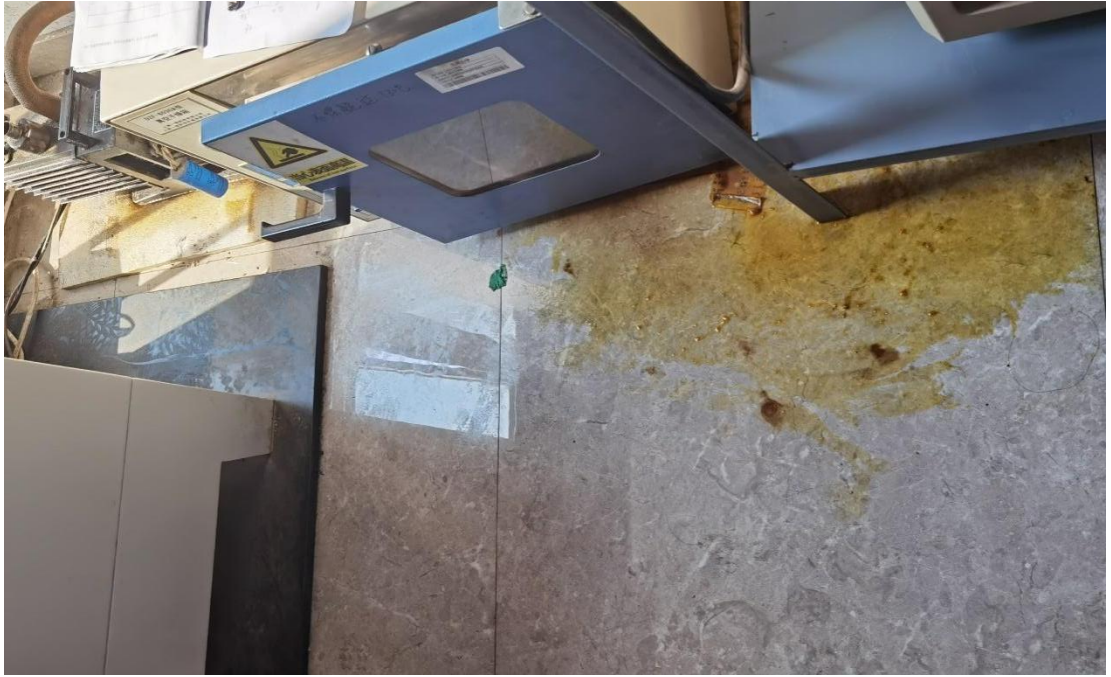
理工楼 1421：机械泵漏油未及时处理
