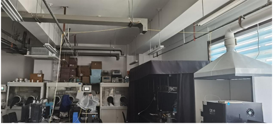
理工楼 1401：电线横跨在消防水管、插线板放在地上
