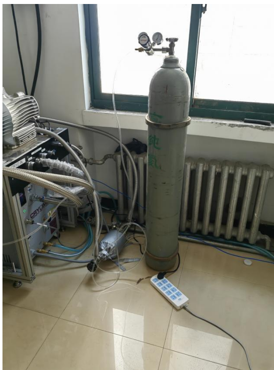
格致楼 1025: 气瓶没有固定、插线板放地面
