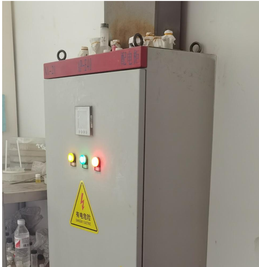
理工楼 1411：化学药品置于配电柜上并已造成管道腐蚀
