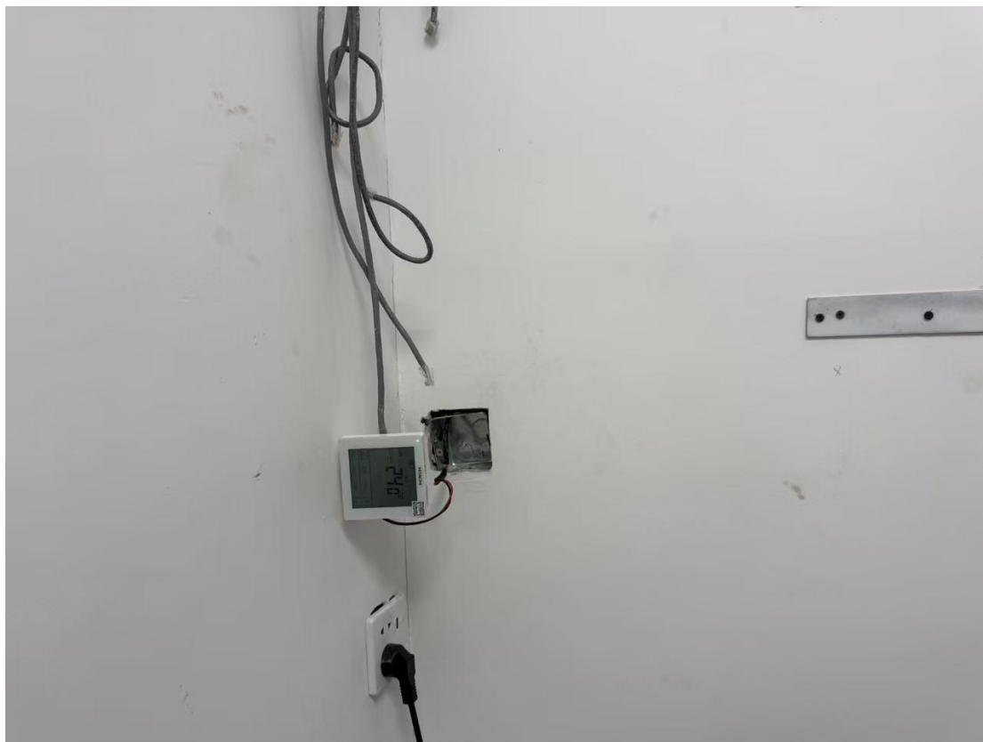
理工楼 1327: 控制器未固定
