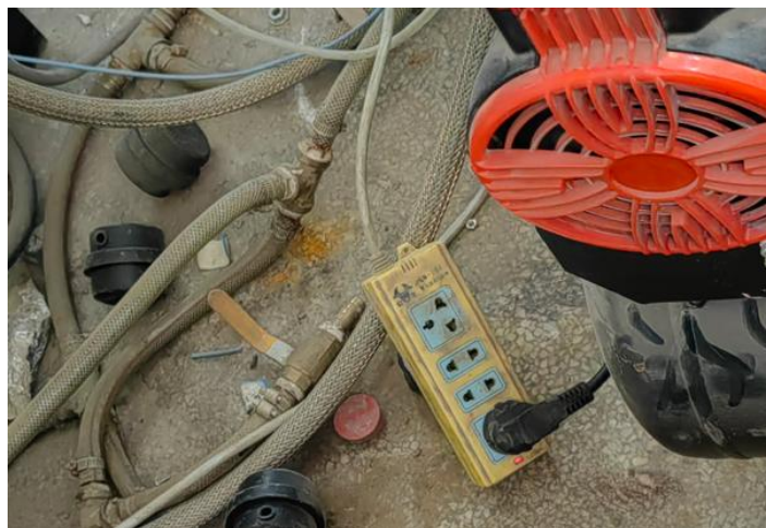
格致楼 1037-1：插线板随意放地面
