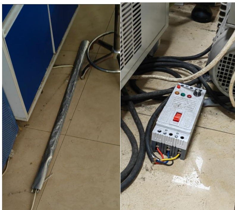
格致楼 1010: 电源开关随地放置、废液桶满建议周一上交回收、过线槽从地面脱落及纸盒随意放置、垃圾桶满溢、插线板放地面
