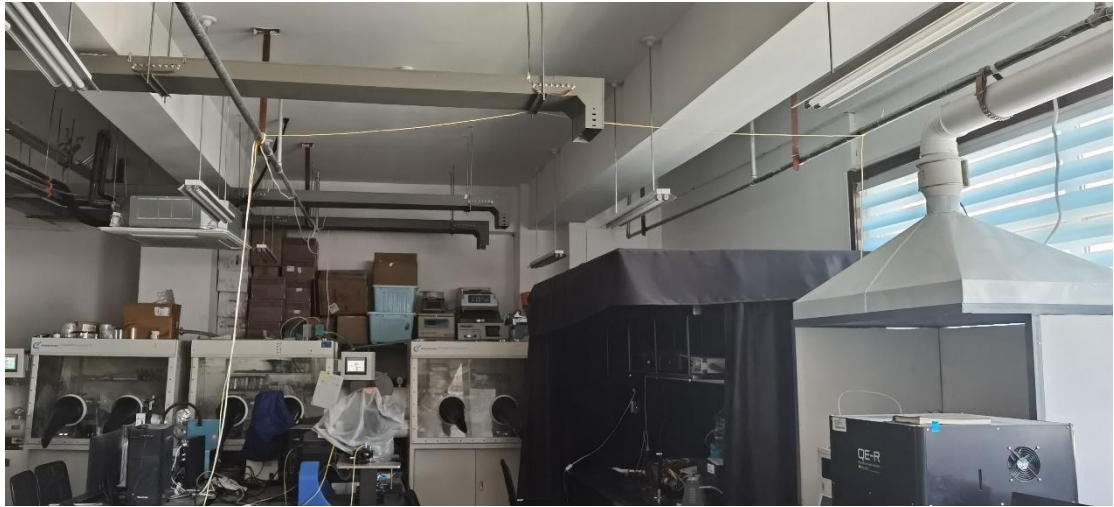
理工楼 1401：电线横跨在消防水管、插线板放在地面
