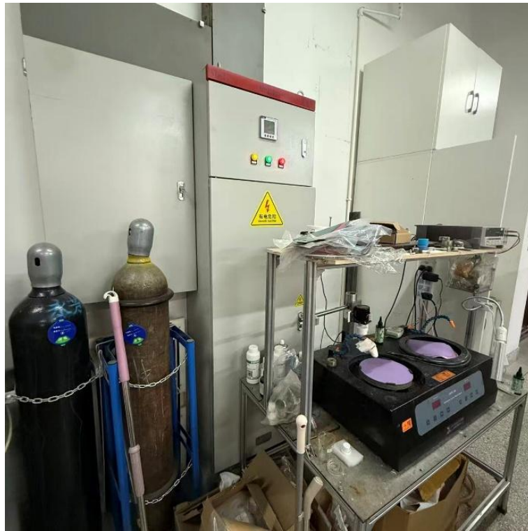
理工楼 111：电源柜门被重物阻挡
