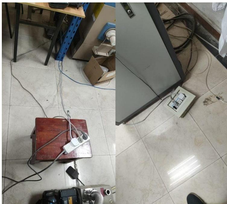
齐云楼 112: 插线板串联, 电箱在地上
